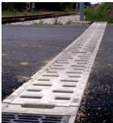
Železniční přejezd Budišov, ACO DRAIN® Monoblock RD 300
