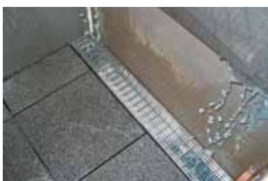
Skrápění fasádního žlabu v instalaci
