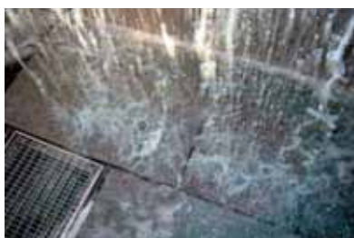
Maximální skrápění oblasti zřetelně ukazuje významnou roli nástavby pro střešní odvodnění
