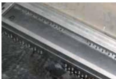
Zkušební instalace s odvodňovací výztuží a ložem z drčeného štěrku před přístupovým rámem k výstupu
