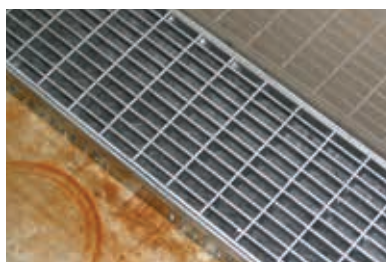
Ein eingelegtes Schmutzvlies reduziert bereits im saubereren Zustand die hydraulische Leistung des Systems um 30%
